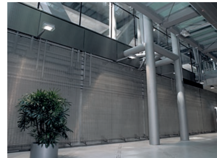
Verkleidung technischer Anlagen. Terminal 2, Flughafen, Köln-Bonn, Deutschland, MULTI-BARRETTE 8124.
