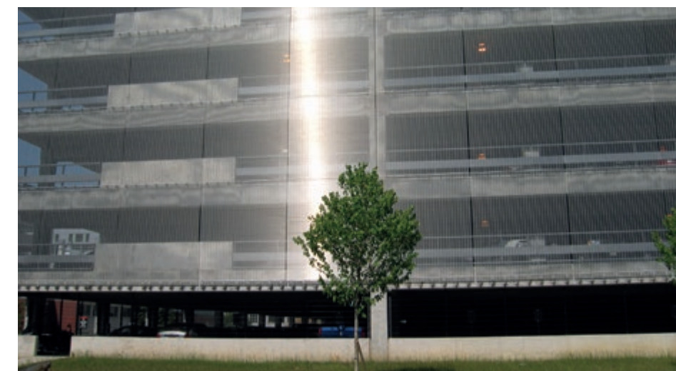
La interacción de las telas de acero inoxidable con la luz solar confiere a las fachadas un elegante aspecto reluciente. Revestimiento de aparcamiento MULTI-BARRETTE 8301, Ohio, EE.UU.
