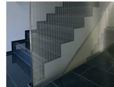
Protección contra caídas en el hueco de la escalera con revestimiento de malla metálica de MULTI-BARRETTE.
