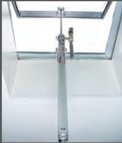
Su cupola con valvola termica
