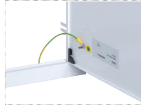
Earth connection cable Câble branchement terre
