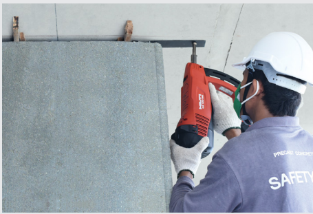
5. ยึดแผ่นด้วยเครื่อง Hilti Gun ซึ่งเป็นอุปกรณ์ ที่ทันสมัยและได้มาตรฐาน ทำให้ยึดแผ่นได้ แน่นหนาแข็งแรง เพิ่มความสะดวกและรวดเร็ว ในการติดตั้ง
