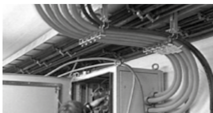
Instalações gerais de potência e dados em fábrica
