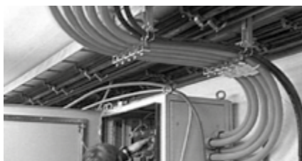
Instalaciones generales de potencia y datos en fábrica. General power and data installations in the factory
