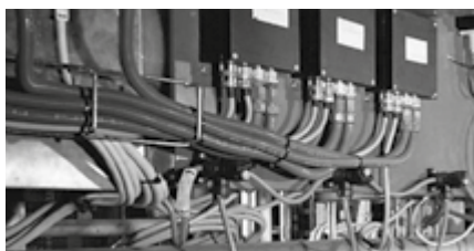
Protección de cableado para conexión de máquinas. Cable protection for machine connections.
