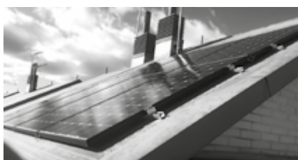
Protection et cheminement des câbles pour toitures photovoltaïques
