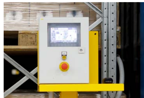
Lättmanövrerat – En användarvänlig och tydlig pekskärm på manöverskåpet låter operatören flytta de mobila baserna på ett enkelt och säkert sätt.
