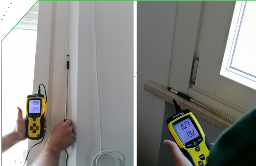
Genauere Analyse mit Thermo-Anemometer an der seitlichen und unteren Fugenverbindung.
