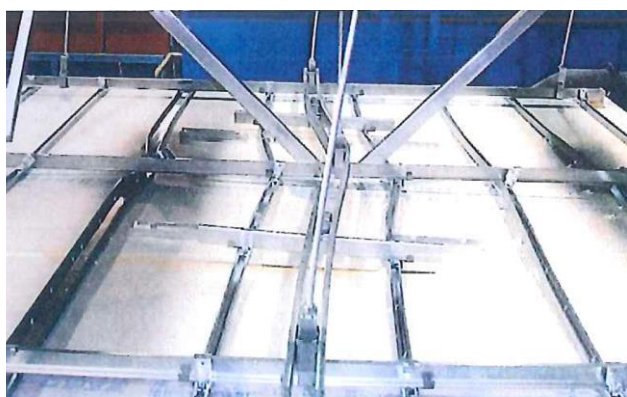
写真-4 破壊状況：補強野縁受けの曲げ変形 野縁の曲げ変形
