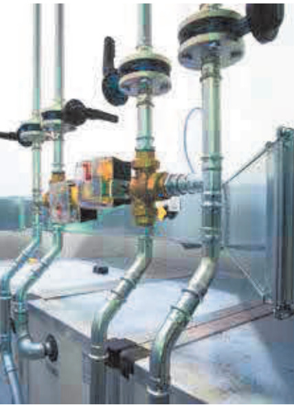
Fig. 15 - Instalación de calefacción industrial.
