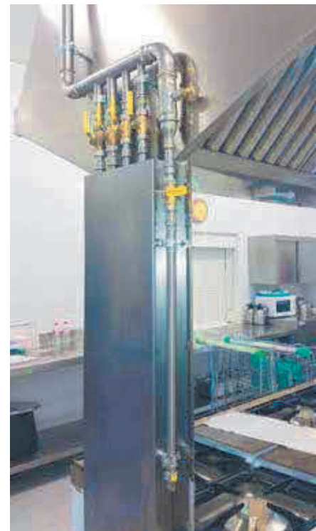
Fig. 24 - Instalación gas en cocina.
