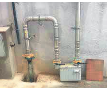
Fig. 23 - Instalación gas en industria.
