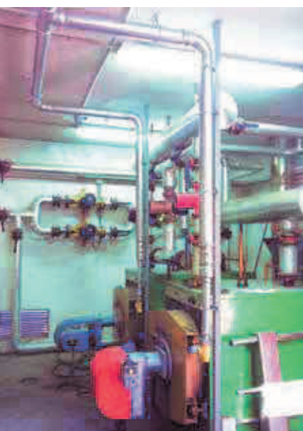
Fig. 22 - Instalación gas para quemadores en caldera industrial.
