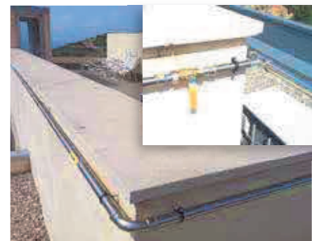
Fig. 25 - Instalación gas en apartamentos comunitarios
