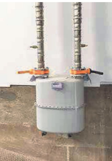
Fig. 21 - Instalación gas en nave industrial
