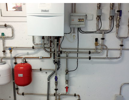
Fig. 5 - Instalaciones de agua caliente sanitaria
