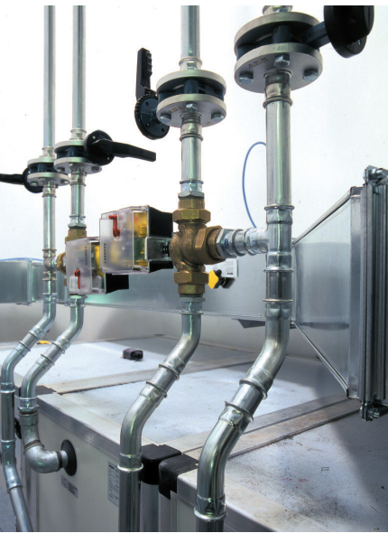
Fig. 15 - Instalación de calefacción industrial.
