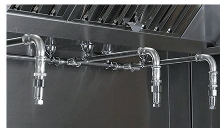
Fig. 10 - Extinción en cocina
