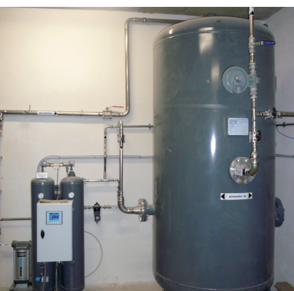
Fig. 7 - Instalaciones de gases inertes
