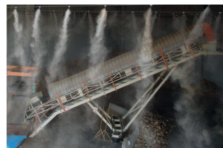
Fig. 12 - Instalaciones de nebulización
