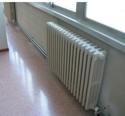
Fig. 16 - Instalación de calefacción por radiador.
