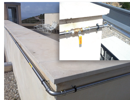
Fig. 25 - Instalación gas en apartamentos comunitarios
