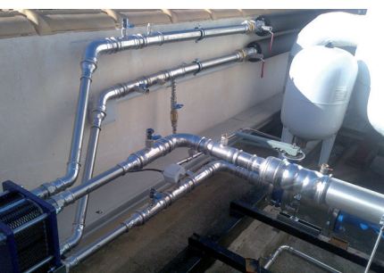
Fig. 6 - Instalaciones de climatización
