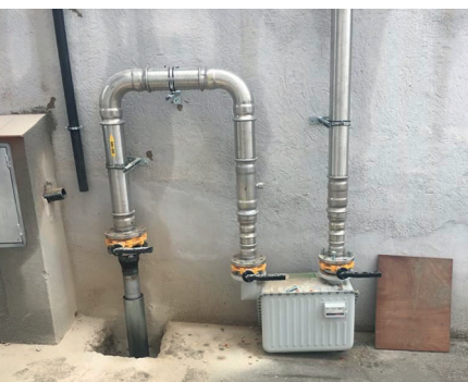
Fig. 23 - Instalación gas en industria.
