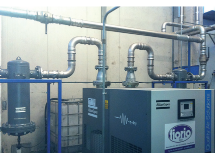
Fig. 8 - Instalaciones de aire comprimido
