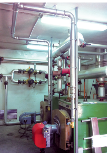
Fig. 22 - Instalación gas para quemadores en caldera industrial.
