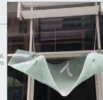
2 broken 6+6 glass plates. 2 plaques en verre 6+6 cassées.
