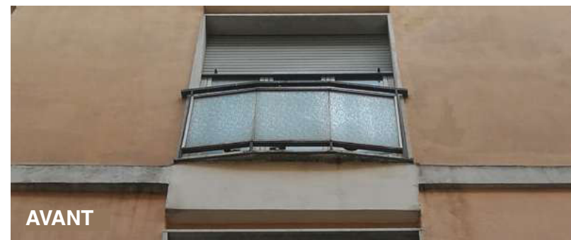
Exemple d'un bâtiment avec des balcons à la française non aux normes en verre armé.
