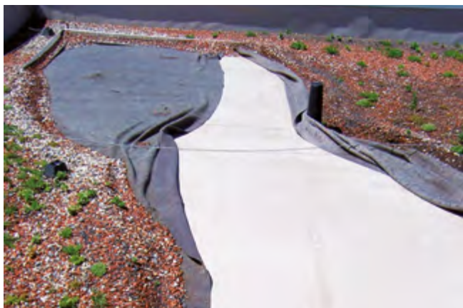
▲ Érosions dues au vent, qui vont ici jusqu'à l'isolation du toit
