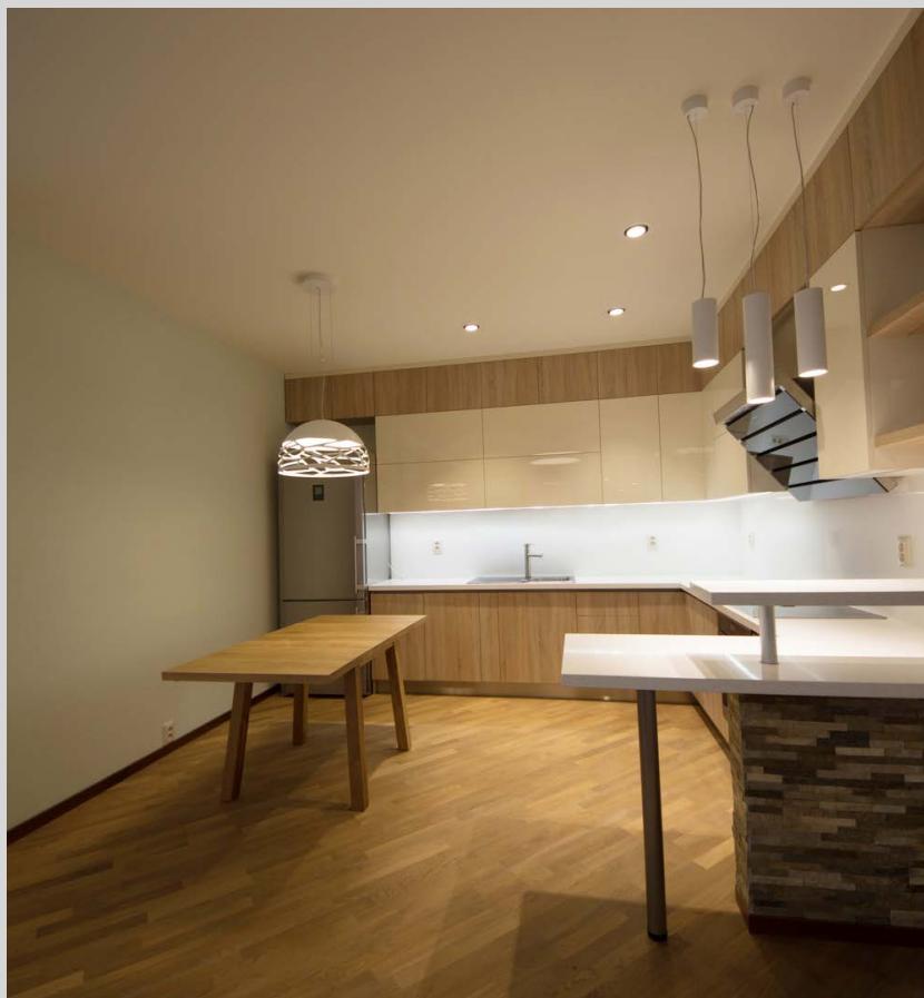
Cuisine - FRANCE Plafond blanc avec intégration lumineuse - Installation : MB Lights
