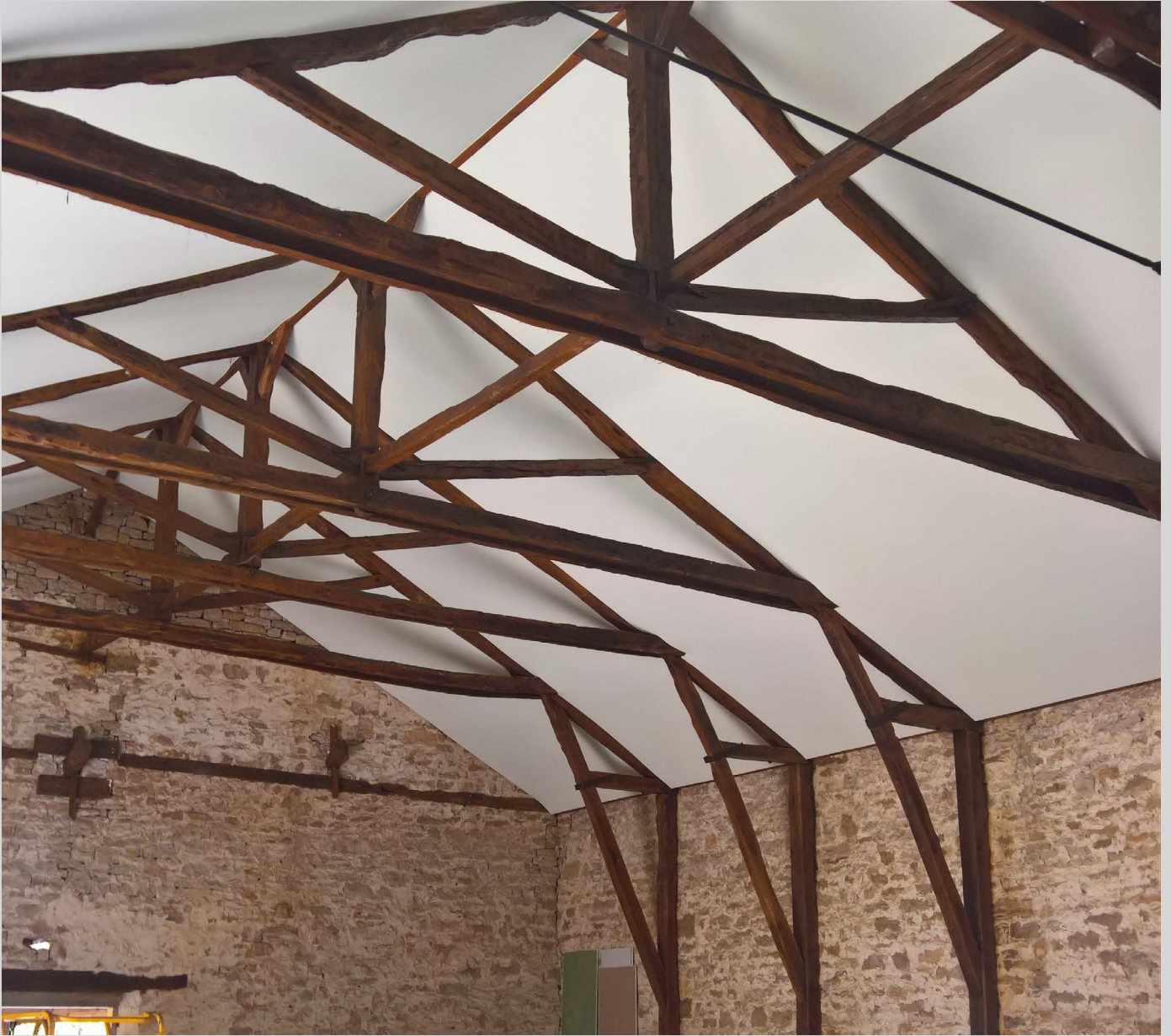
Résidentiel - FRANCE Plafond blanc entre poutres - Installation : SIGNAL SARL
