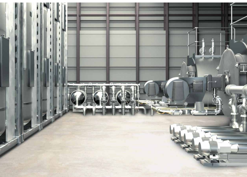
Una planta de producción química con tanques y oleoductos es un ejemplo de una planta del tipo HBV.
