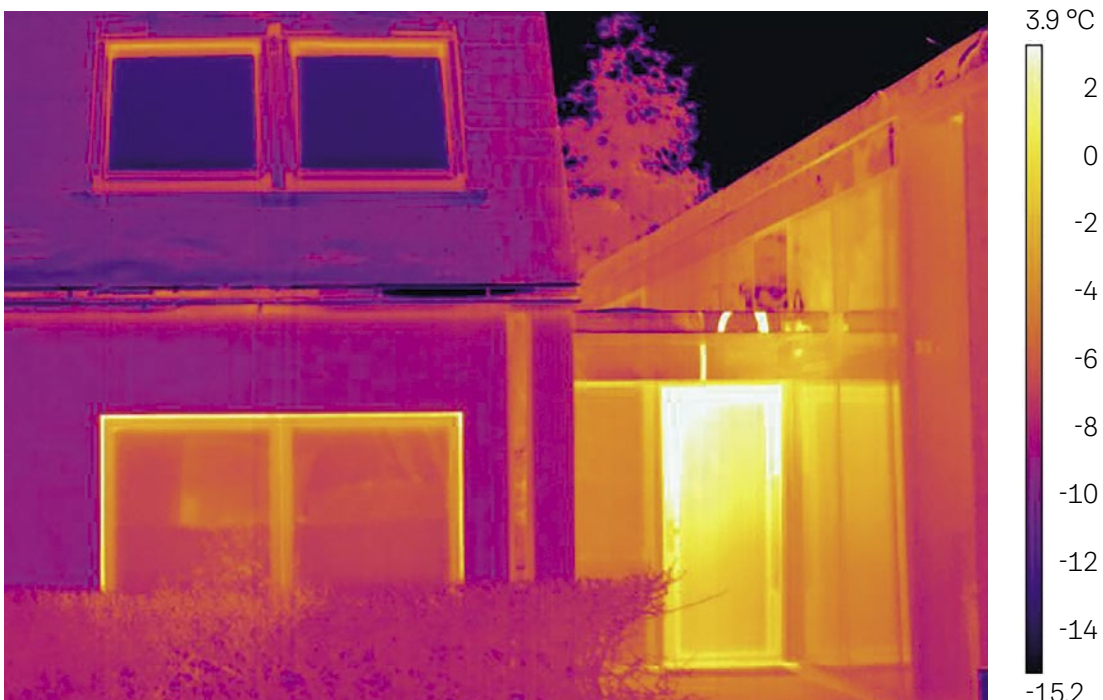
Thermografie von außen zur Visualisierung von Wärmeverlusten
