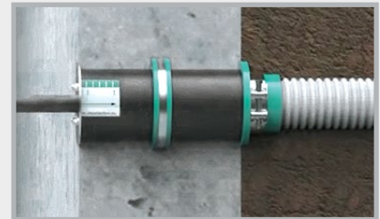
Eingeführte Medienleitung nach der Montage des Dichtungseinsatzes
